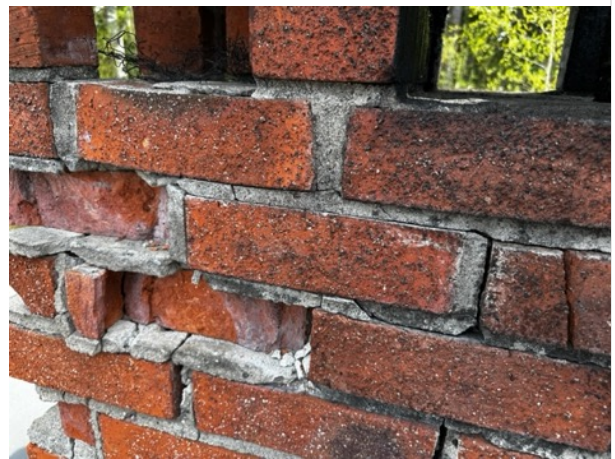
Frostsprängt tegel i skorsten
