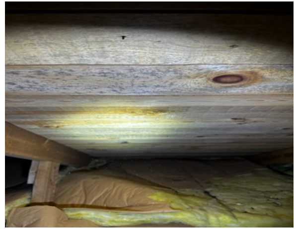
Mikrobiell påväxt på underlagstak
