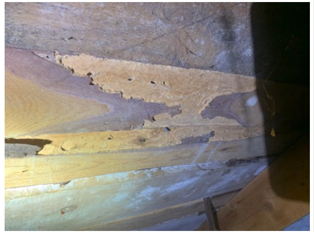
Spår av insekter och mikrobiell påväxt på vind
