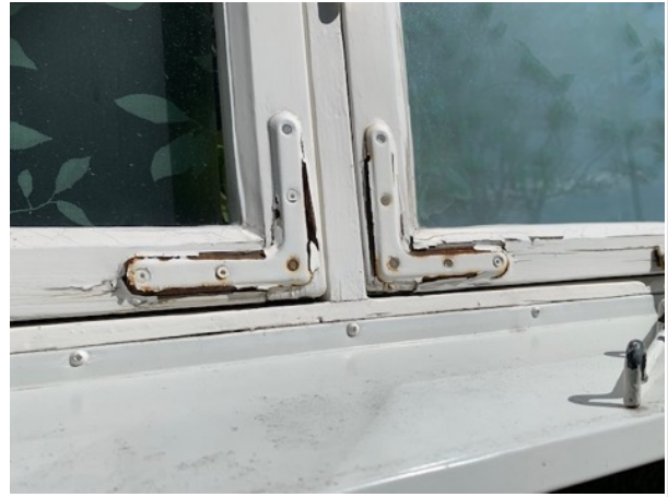
Färgsläpp och begynnande röta på fönster
