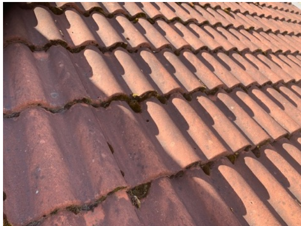
Mossa på takpannor
