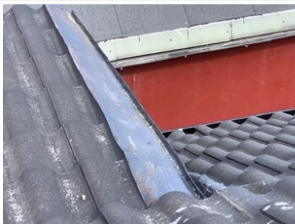
Vindskivebeslag med dålig anliggning
