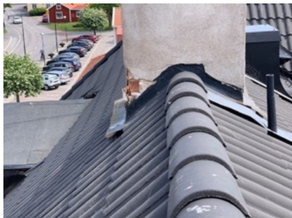
Frostskada på skorsten
