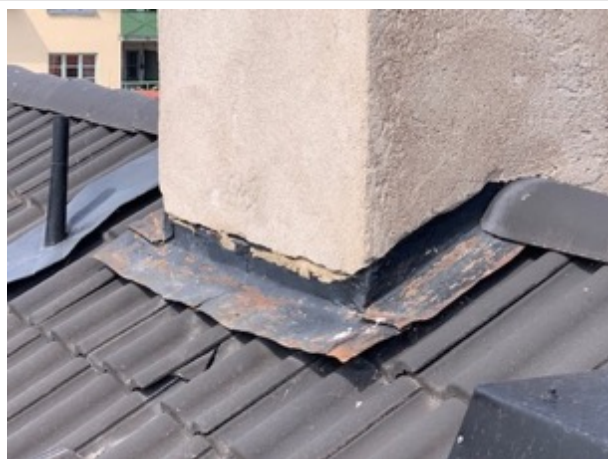
Plåtar runt skorsten med dålig tätning
