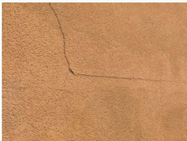
Sprickor i fasad
