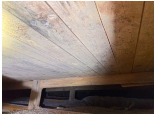
Mikrobiell påväxt på underlagstak
