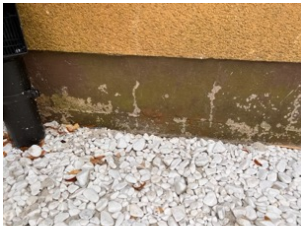
Färgsläpp och sprickor i grund
