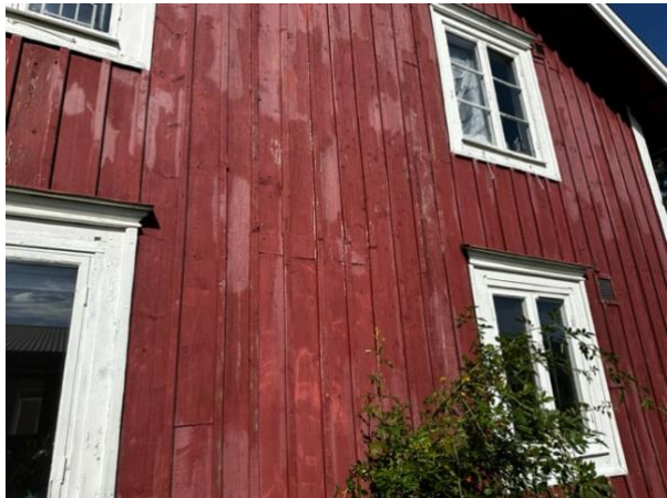
Färgsläpp och torrstrucken panel
