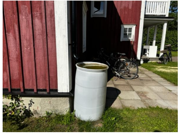
Stuprör leder ej ner i markledning
