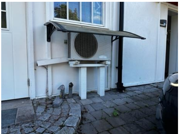
Kondensvatten leder ej ner i markledning
