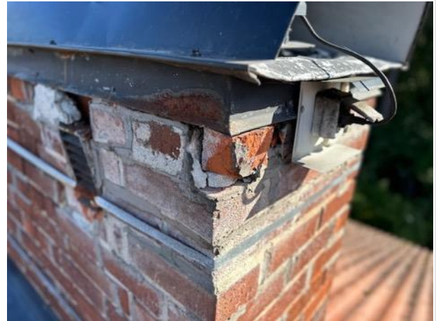
Frostsprängda tegel i skorsten
