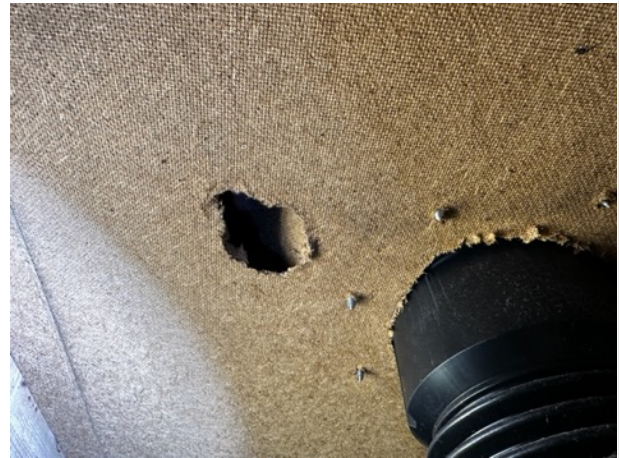
Skada i tak vid avluftningsrör
