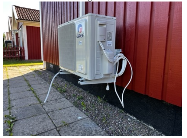
Kondensvatten från lilla kompressorn leder ej ner i markledning
