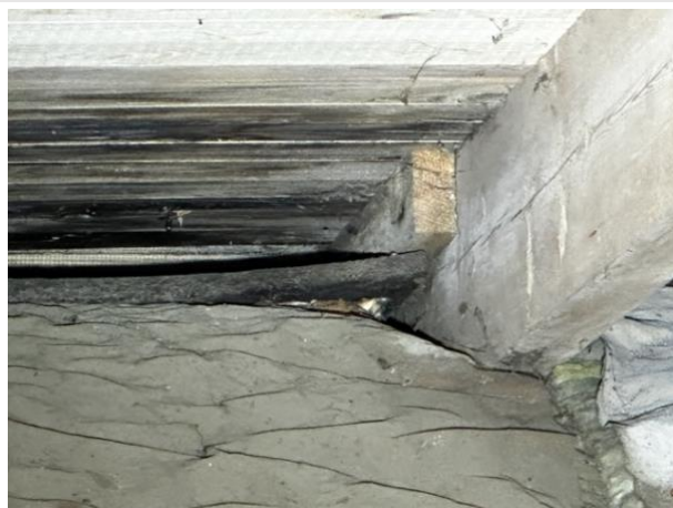
Missfärgning på vind
