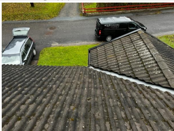
Mossa på takpannor
